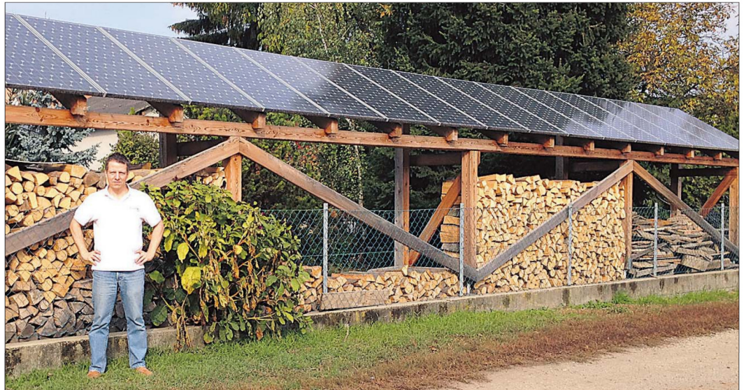
Christian Bruckner setzt auf erneuerbare Energien. Sein Ziel: Unabhängig von allen Energieversorgern zu werden. Die bestehende Anlage soll dafür weiter ausgebaut werden.
